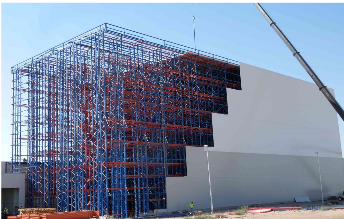
Fig. 21. Estrutura de armazenagem porta-paletes seletivo autoportante
